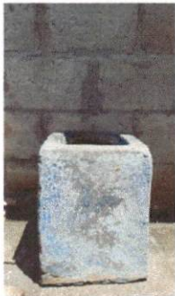
Foto 9: Desprendimiento de la letrina
